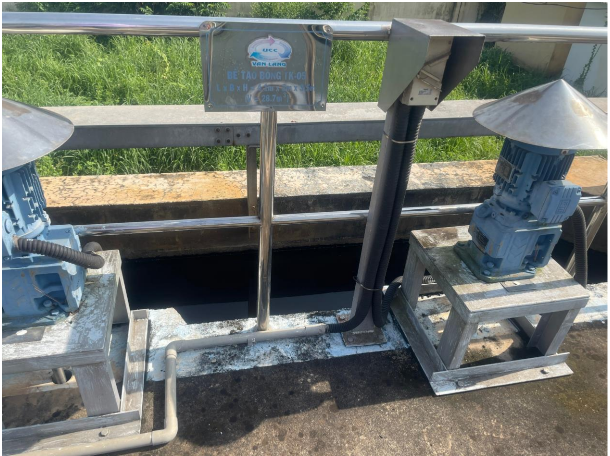
Bể keo tụ, tạo bông
