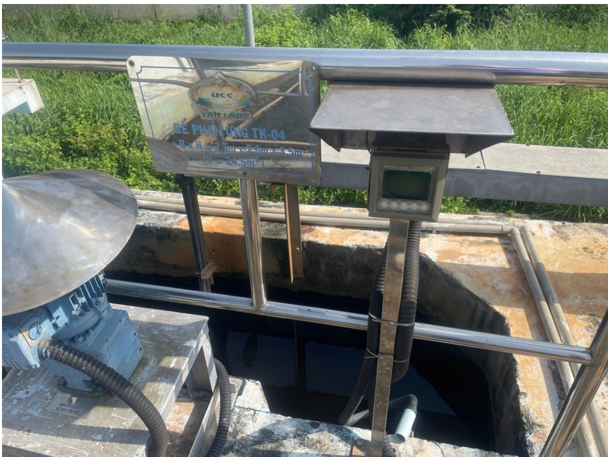
Bể phản ứng
