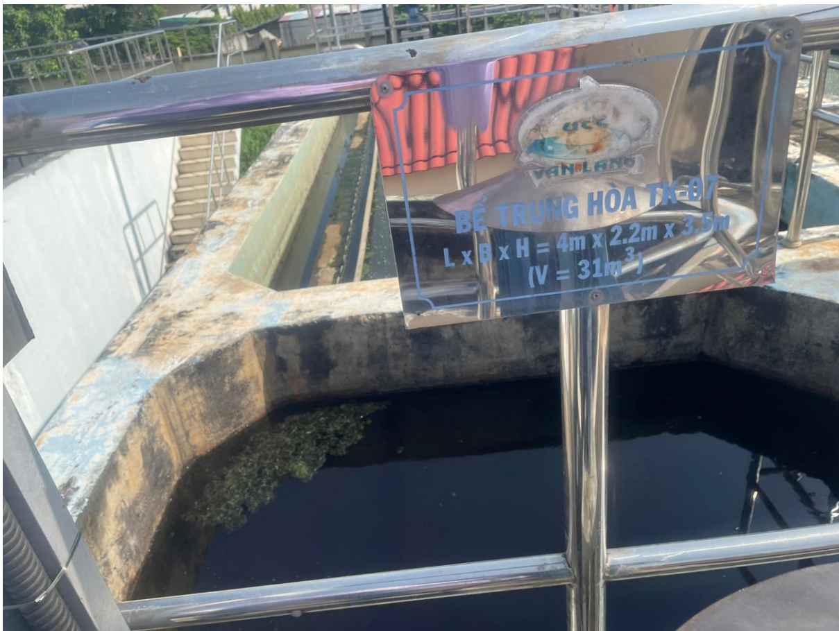
Bể trung hòa
