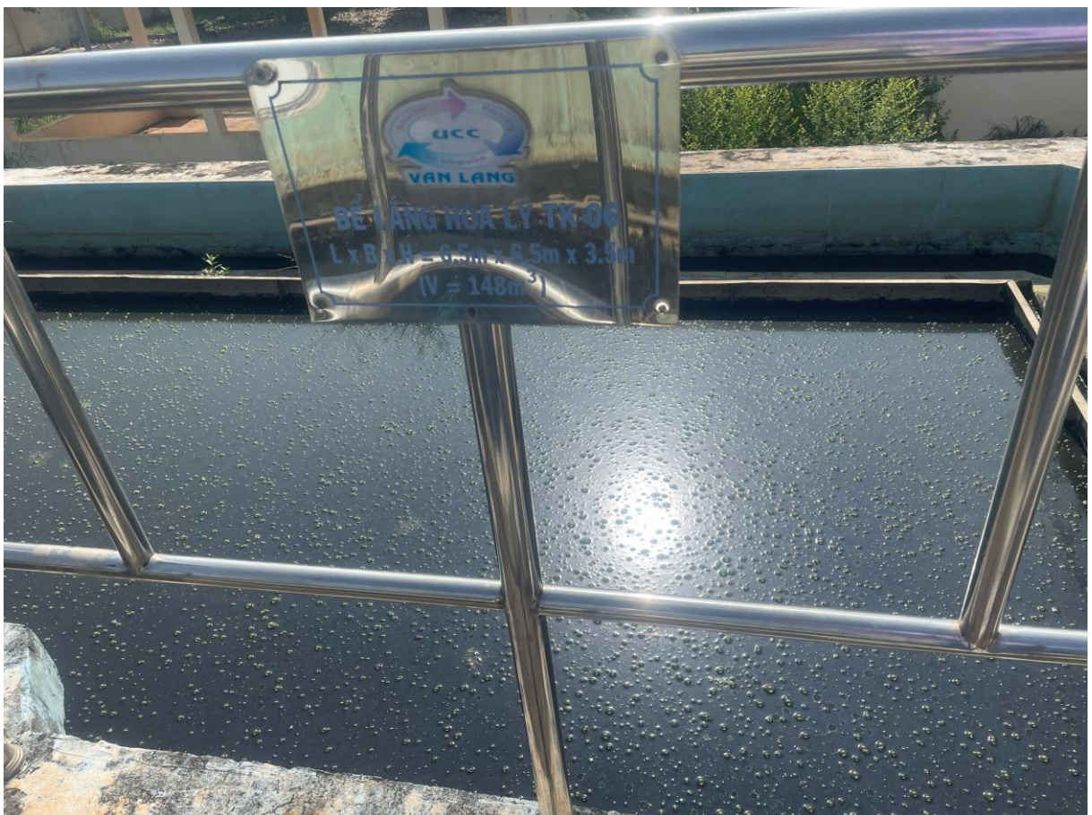
Bể lắng hóa lý
